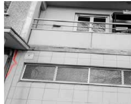
Fissures structurelles préoccupantes
